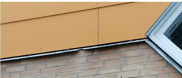
Skade på sålbænk under facadeplader.
