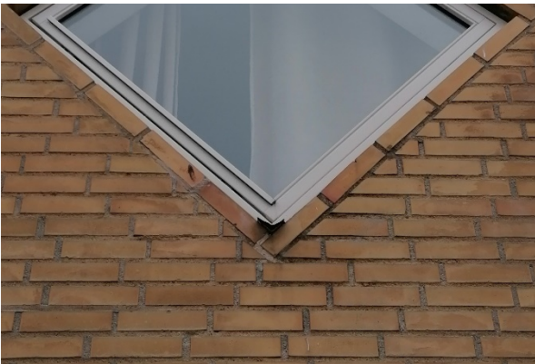
Her mangler sålbænk. Medfører at murværk er opfugtet og fuger porøse.
