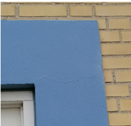
Revne i facadepuds
