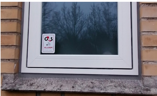
Intakt elastisk fuge
